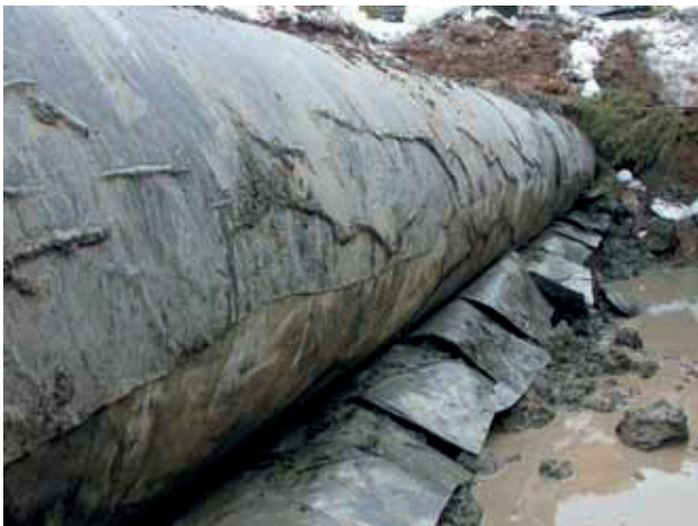
▲ Рис. 1. Пропуски мастичного слоя, неподготовленная поверхность трубы
