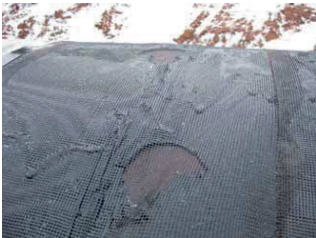
▲ Рис. 2. Воздушные пустоты под слоем защитной обертки
